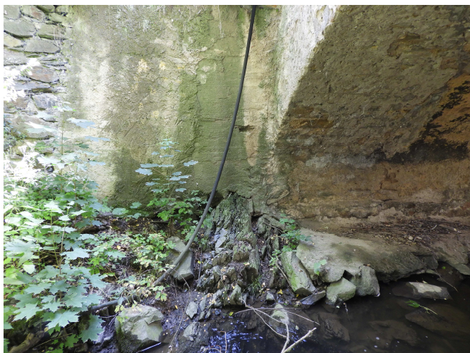
Nefunkční podemleté obetonován základů
