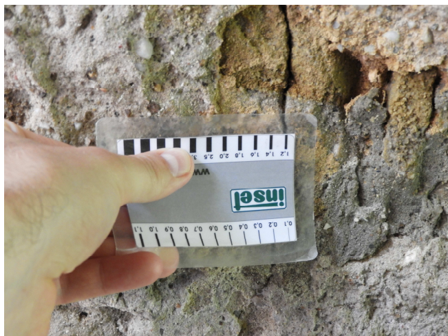
Trhлина v klenbě mostu v Květnici
